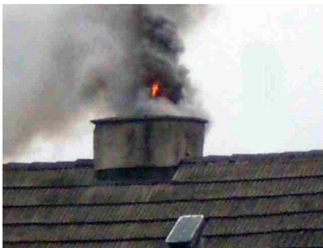
Pożar w kominie – zapłon kondensatu.
