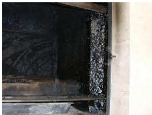
Widok paleniska opalanego mokrym drewnem, osadzona szklista maź.
