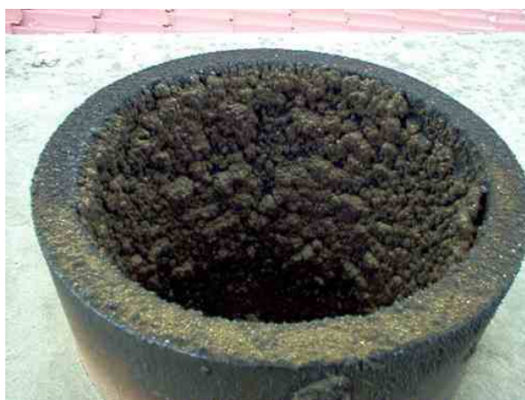
Fragment kształtki kominowej – osadzenie kondensatu.
